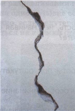
Рис. 45. Общий вид трещины на штукатурке
